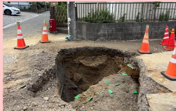
神谷5丁目陥没の状況
