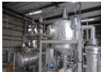
BDF 製造施設
