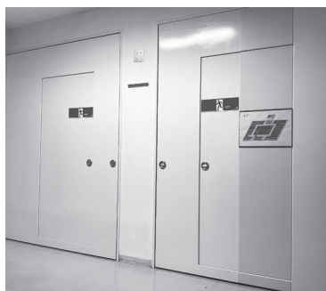
市役所に設置されている防火シャッター
