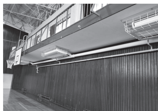
栃木県小山市の学校体育館エアコン
