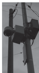
道路に設置されている防犯カメラ
