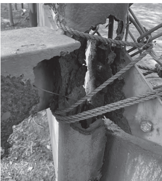
腐食が進んだ野球用バックネットの支柱。早期の修繕が待たれる。
