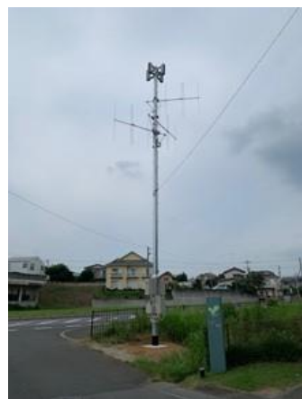
写真：防災行政無線
