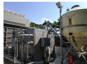
ペレット焚き冷温水機(空調機)
