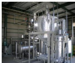
BDF製造設備
