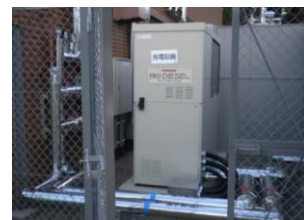
コージェネレーションシステム(発電機)
