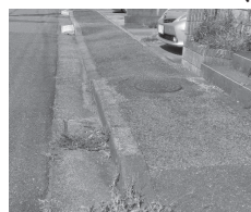
斜めの部分も多く歩みにくい歩道
