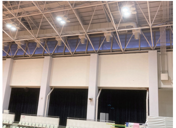
改修が待たれる牛久運動公園体育館屋根
