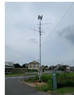
写真：防災行政無線
