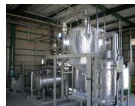
BDF製造設備
