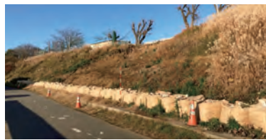
崩壊した法面
