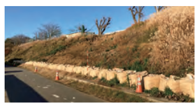
崩壊した法面
