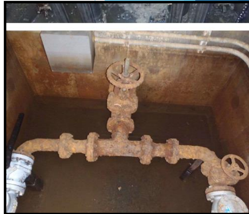
汚水ポンプ室 バルビピット内 弁類腐食
