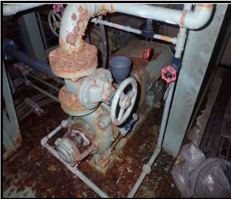
汚水ポンプ場 給水設備 腐食劣化
