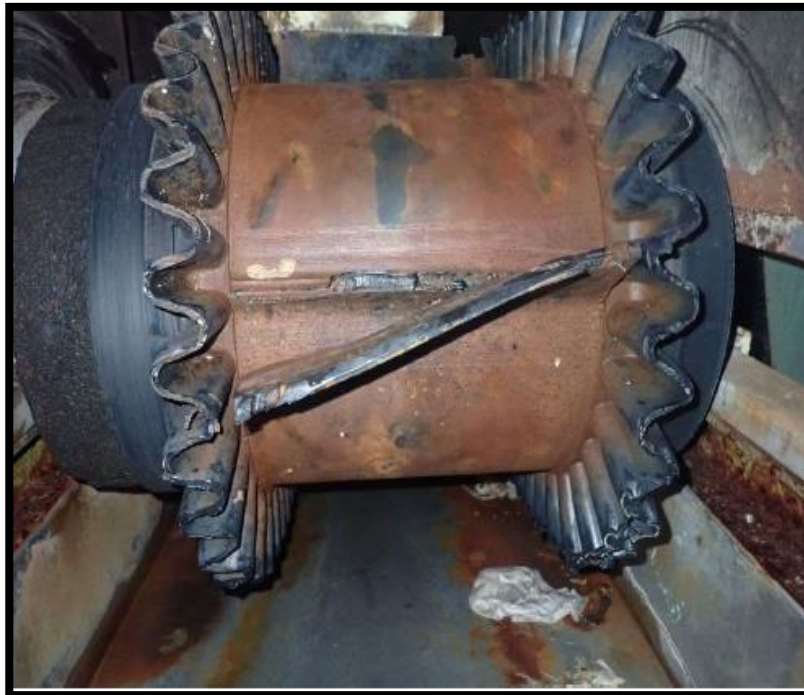
汚水ポンプ場 し渣搬出機 劣化破損
