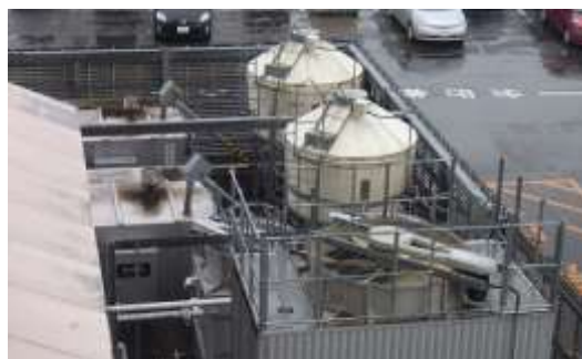
ペレット焚き冷温水器（市役所敷地内）
