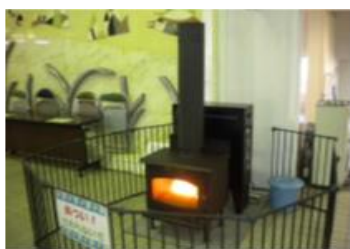
木質ペレットを使用するストーブ (公共施設に111台設置)
