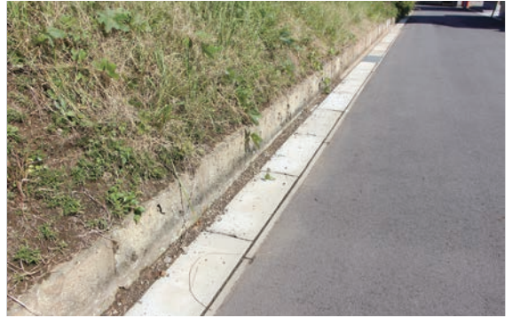
蓋掛けしてあるU字溝
